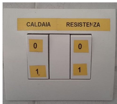
Vypínače na teplou vodu a topení umístěné v kuchyni
